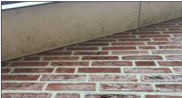
Dakoverschot sluit nauw aan op de buitengevel waardoor vleermuizen de spouwmuur niet kunnen bereiken
