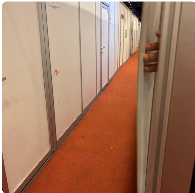
Figuur 2f: Schotten van een privéruimte sluiten niet goed aan. Er is geen plafond en de deur kan niet op slot. Op de foto toont een vader met zijn hand dat de schotten onvoldoende afsluiten. Kinderen en jongeren ervaren de binnenruimte daardoor niet als een veilige privéruimte (bron: Onderzoeksraad voor Veiligheid).
