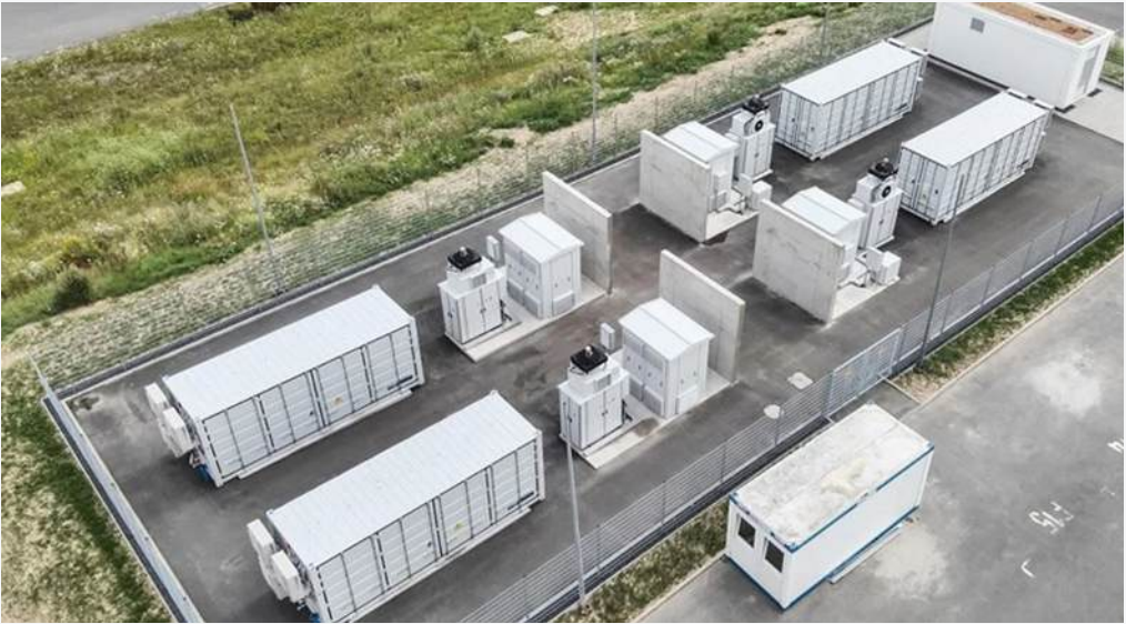
Figuur 36 | Voorbeeld van een 5 MW / 20 MWh BESS
